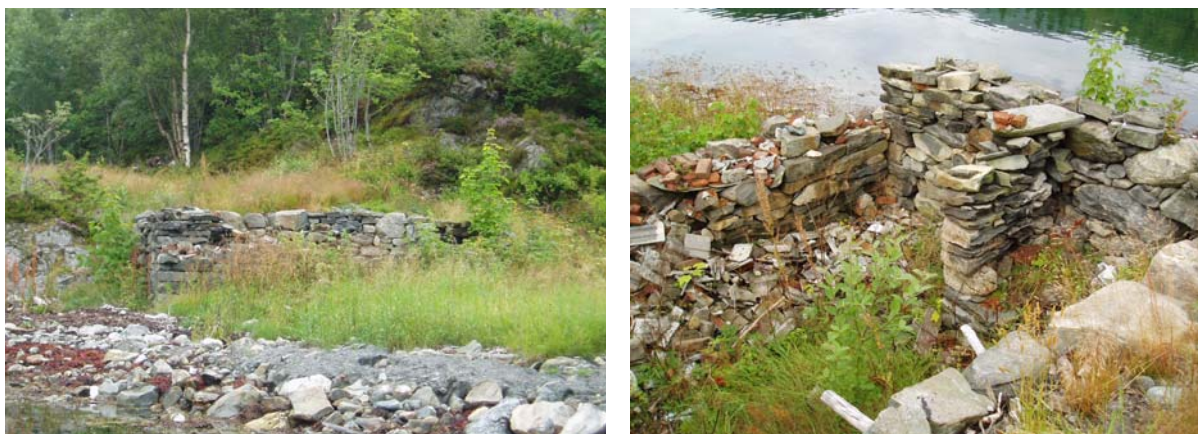
Figur 13 Bildet til venstre viser grunnmurens plassering i terrenget, rett bak grunnmuren går veien nordover inn til fastland. Bildet til høyre viser hva slags forfatning muren er i per i dag.
